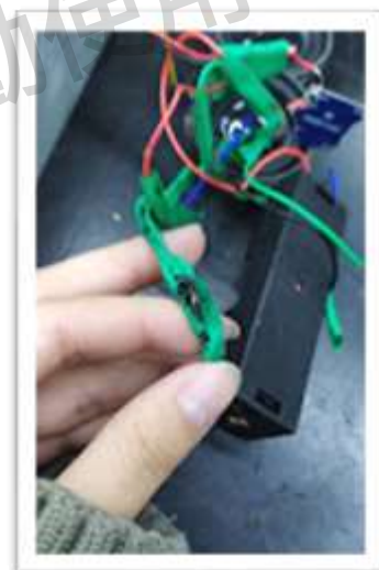
圖 9 組裝時電線燒壞
